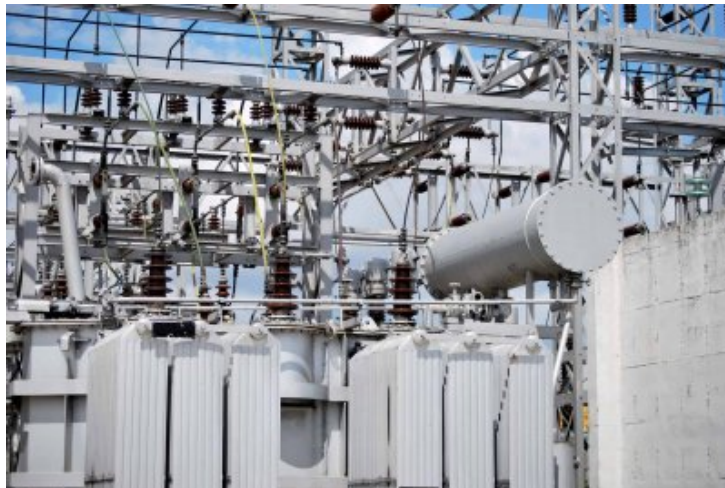
Mégamachine : décortiquer et comprendre les gigantesques infrastructures électriques et numériques Transformateur électrique
