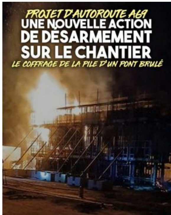
A69 : nouvelle action de désarmement : un coffrage de pont incendié
